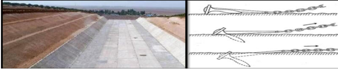
Şekil 12 - Kanal temsili beton kaplaması ve olası demir atma hasarı (2)
