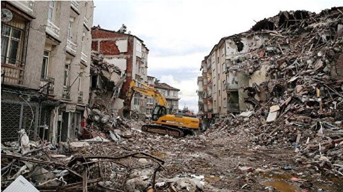
Şekil 18 - Afyonkarahisar, Dinar Santral caddesi ağır hasarlı yapıların yıkımı [38].
