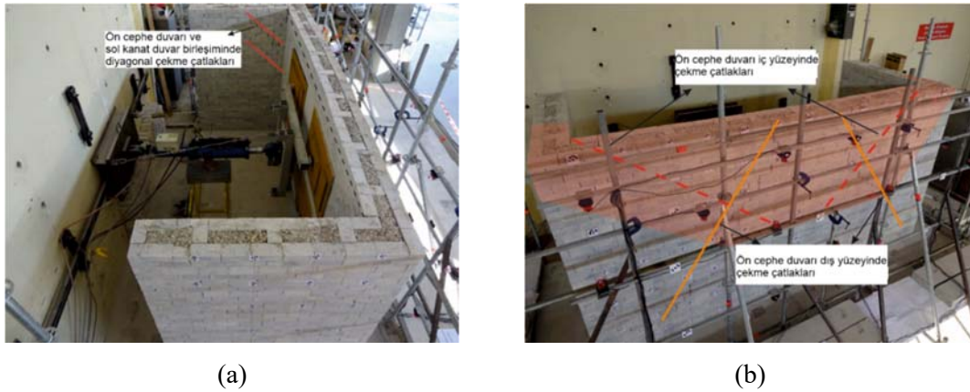
Şekil 7 - TMW numunesinde (a) birleşimde gözlenen hasar, (b) devrilme mekanizması.
