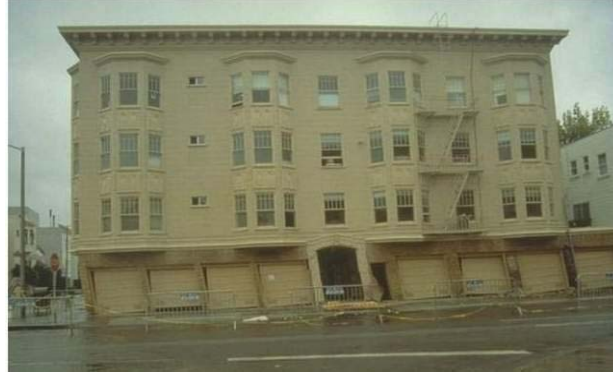
Şekil 2 - Çok üniteli ahşap bir yapıda yumuşak kat hasarı (UC, Berkeley).
